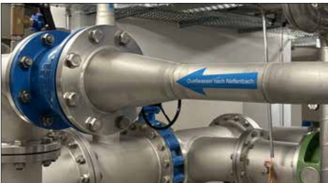
Bild: 4 Durch dieses Rohr kommt viel Trinkwasser nach Neftenbach
